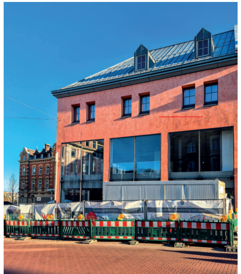
Großbaustelle im ehem. H&M. Der Eigentümer investiert einen Millionenbetrag in das Gebäude. Hier zieht ein Hofer IT-Unternehmen ein und der Woolworth um.
